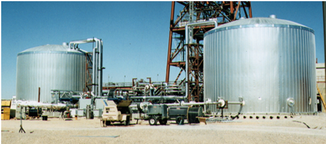
Figura 18. Serbatoi di accumulo dell'impianto SOLAR TWO, California (USA)
