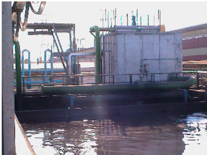
Sezione trattamento acque di controlavaggio
