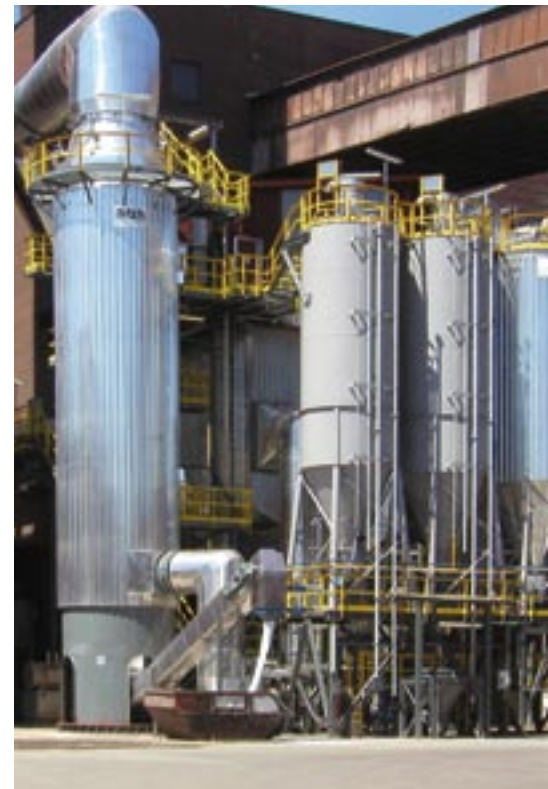
MEROS plant, voestalpine Stahl, Linz, Austria
